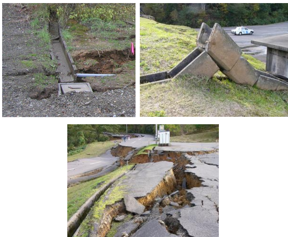
写 3-13 排水施設の変状の例
