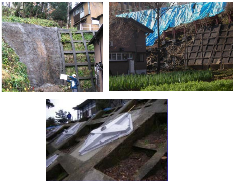
写 3-12 のり面保護工の変状の例
