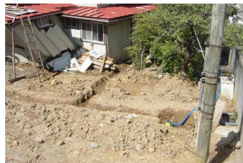
(b) 地震により湧水が出た箇所
