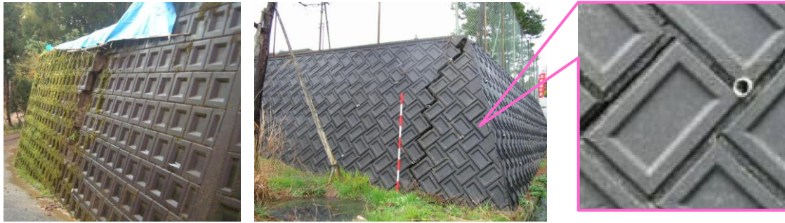
(a)水抜穴が無い前傾した擁壁 (b)水抜穴が20mmと小さい事例 写3-1 擁壁の水抜穴規格の不具合の事例
