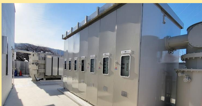
ガス絶縁開閉装置（手前）及び主変圧器（奥）
