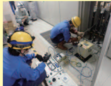
●絶縁耐力試験
