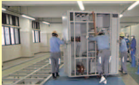
●電気室内での電気盤の移動
