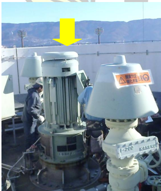
消化タンクの上。黄色の矢印の部分が攪拌装置。 これはずして点検・修理を行ないます。
