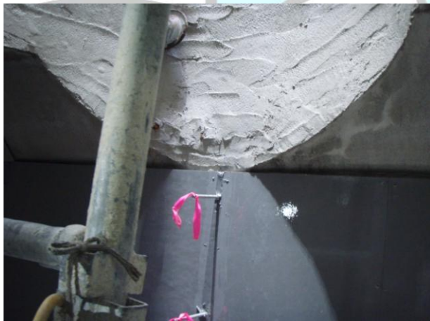
上部はマンホールの立ち上がり部分で、劣化した部分を削り、モルタルで補修。その下はボードを張り終わっています。立ち上がり部分も同様にボードが張られます。
