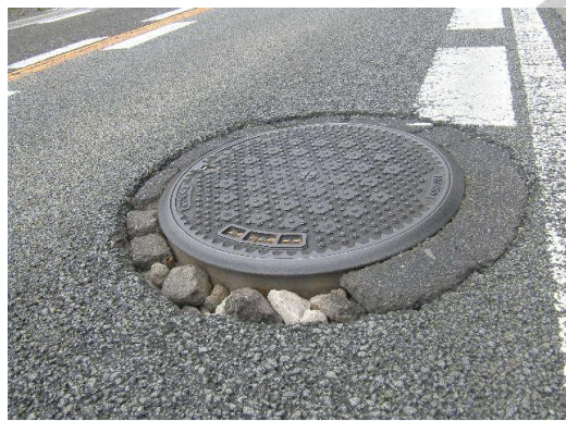
マンホール周辺の舗装がいたんでいました。
