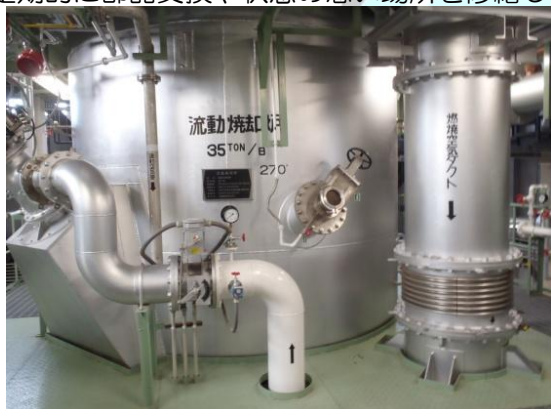
流動床式焼却炉
