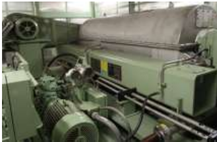
1号汚泥脱水機
