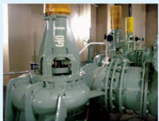
主汚水ポンプ
