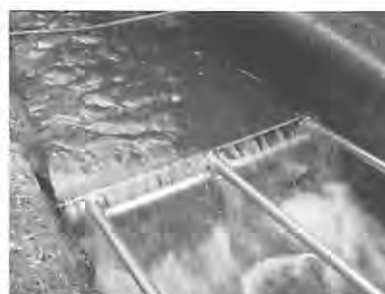
図 1 水路に設置した遡上防止工
