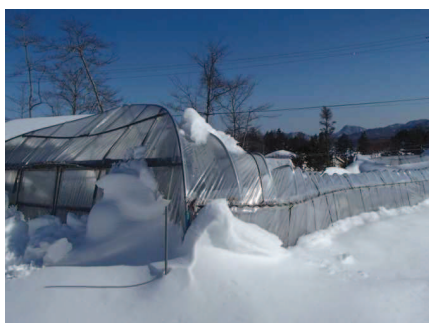
(農業用施設被害状況)
