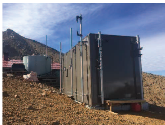
＜御嶽山に整備した携帯電話基地局＞
