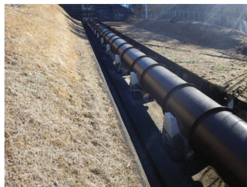
（県営小洪第2発電所）
