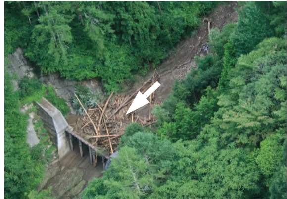
(砂防指定地小田井沢川 岡谷市湊) ※土石流を捕捉し、下流の被害を防止する砂防堰堤
