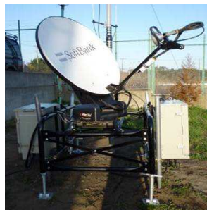
(可搬型移動基地局)
