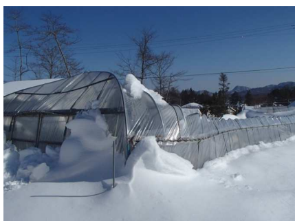
(農業用施設被害状況)
