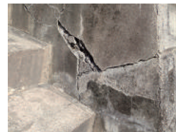
壁のひび割れ
