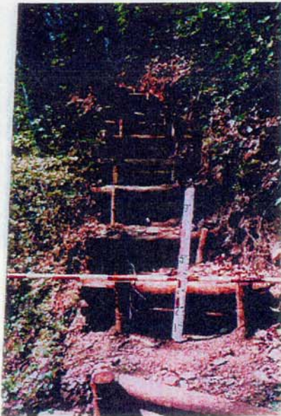
施工後1年未満 補修前
