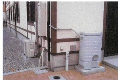
雨水貯留タンク(兵庫県HP)
