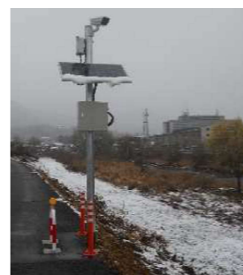
簡易型 河川監視カメラ
