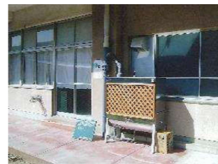
雨水貯留タンク設置例
