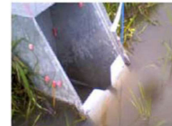
水田排水口の調整装置 設置例
