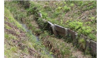
老朽化し、崩落し始めた幹線排水路、機能を維持するための更新が
