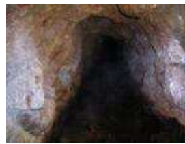
素掘隧道で崩落の危険あり
