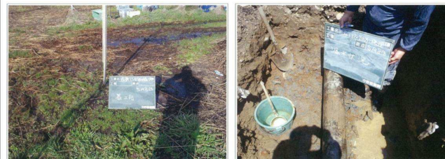
破管したため、畑地の地表に水たまりが発生している。漏水状況の確認
