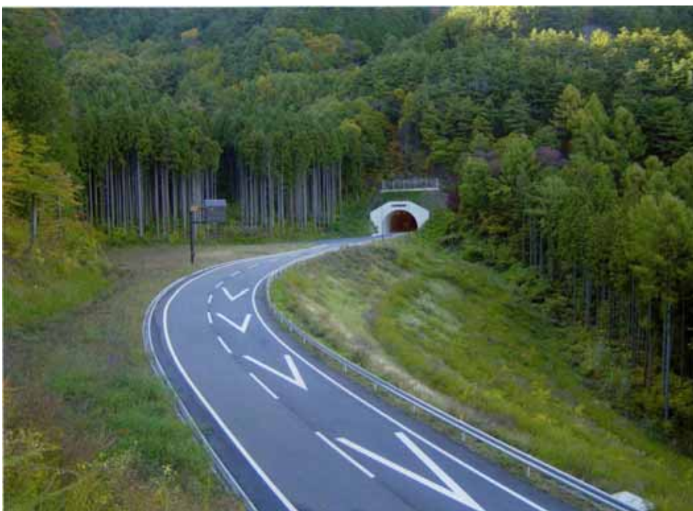
(主)大町麻績インター千曲線 千曲市～筑北村 坂上トンネル L=1,513m
