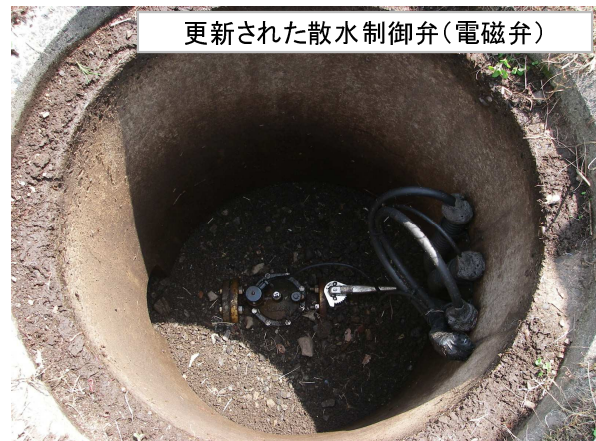
更新された散水制御機器
