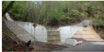
集落を保全する治山施設(谷止工)
