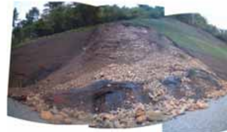
林道法面の崩落
