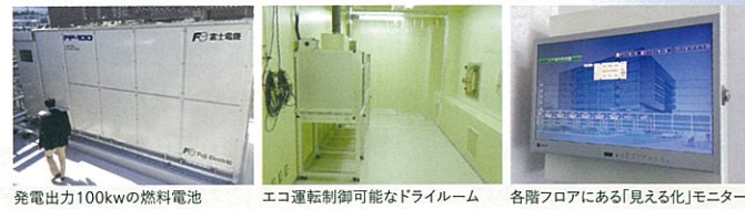
発電出力100kwの燃料電池 エコ運転制御可能なドライルーム 各階フロアにある「見える化」モニター
