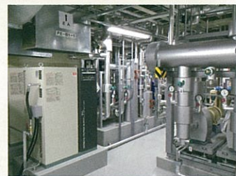
センター地階にある地下水関連装置
