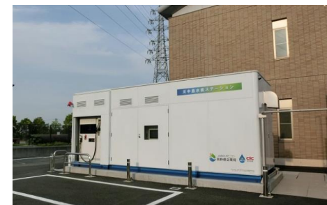
川中島水素ステーション
