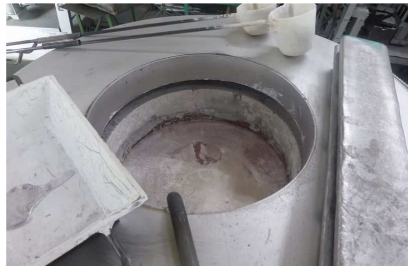
アルミを溶解した状態。溶解したアルミを炉内で一定温度に保持することが可能。
