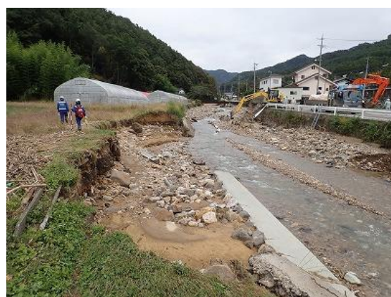
写真-8 余地川被災状況写真
