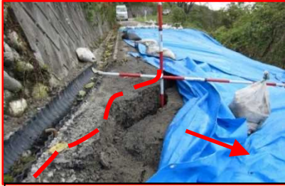
村道崩落状況(平成29年当時)
