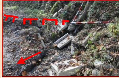
水路損壊状況(平成29年当時)
