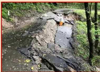
村道崩落状況(令和2年当時)
