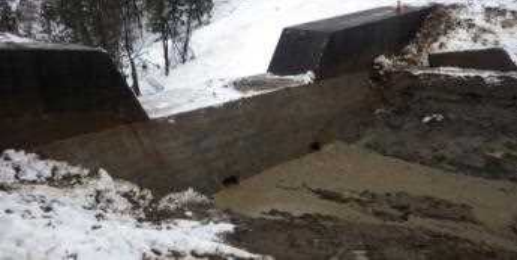
⑬ 千沢 小谷村 中土 【砂防】既設砂防堰堤の除石工事 高地砂防堰堤 (H26 12/1~12)
