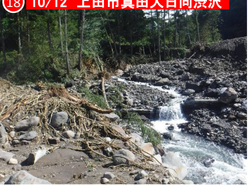
【被害状況】人的被害なし
