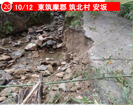
【被害状況】人的被害なし
