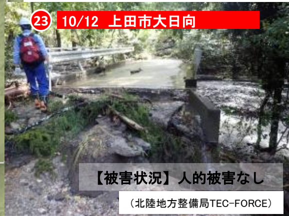
【被害状況】人的被害なし
