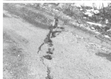
同左、被災状況
