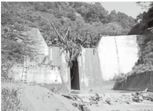
桑名川砂防堰堤（被災状況）（飯山市）
