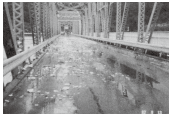
千曲川 橋面まで、ゴミが乗り通行止となった立ヶ花橋
