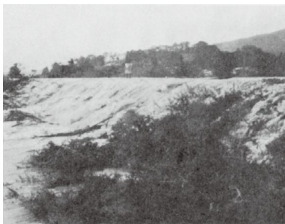
千曲川の背水により溢水中の樽川堤防（飯山市）
