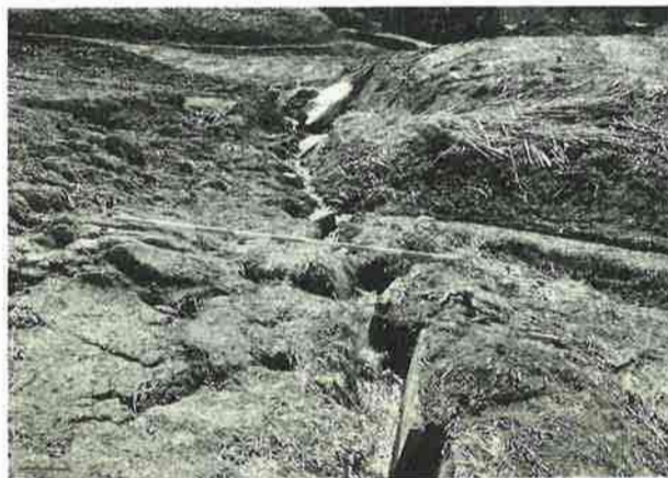
既設水路工の被災状況
