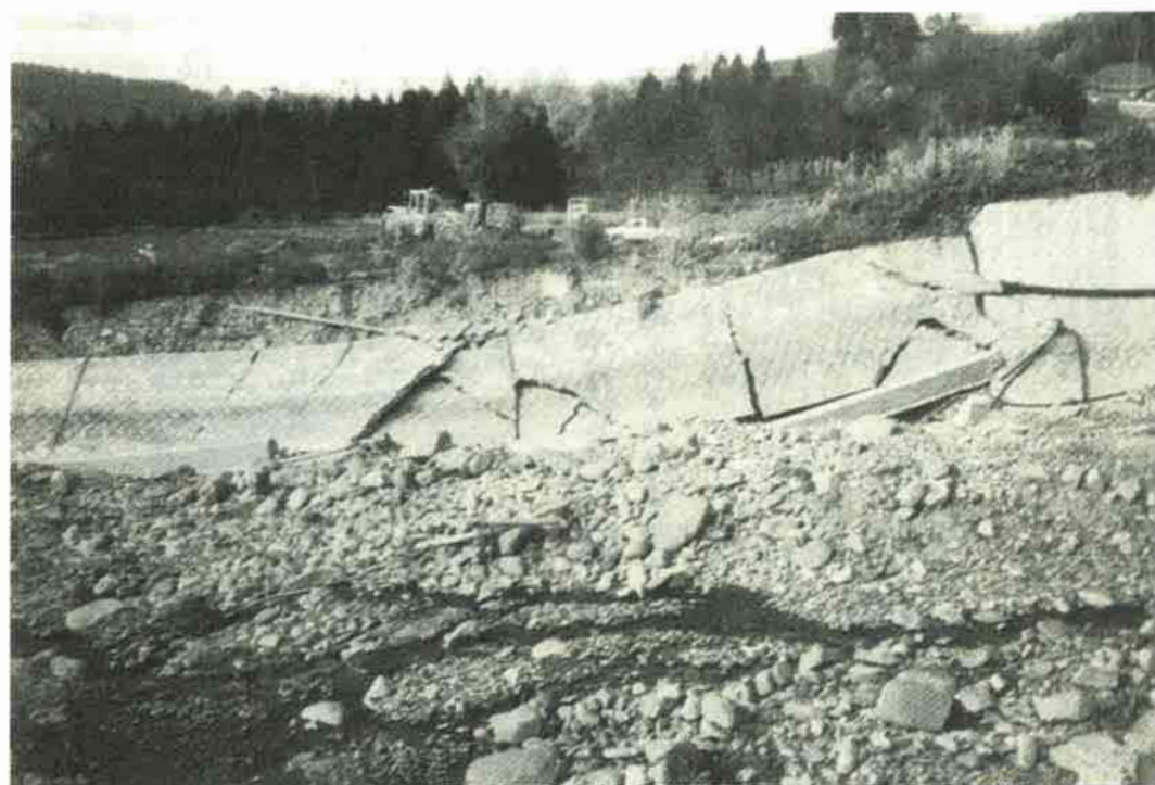
白沢川下流部被災状況
