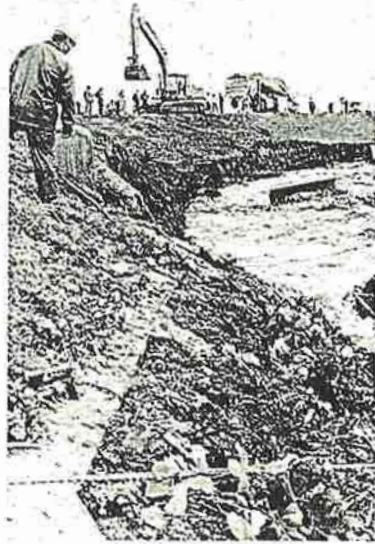
新しい堤防が下から削られた樽川左岸（飯山市水島山地区）
