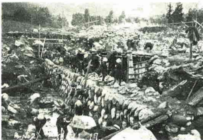
農村振興土木事業として施行された夜間瀬川支川角間川 における石積み堰堤工事の状況（昭和7年11月撮影）
