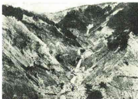
牛伏川上流支溪日影沢の荒廃箇所に施工された積苗工の状況(明治44年撮影)
