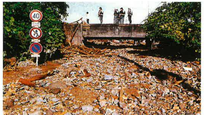
昭和58年9月 台風による砥沢川の土砂流出状況
