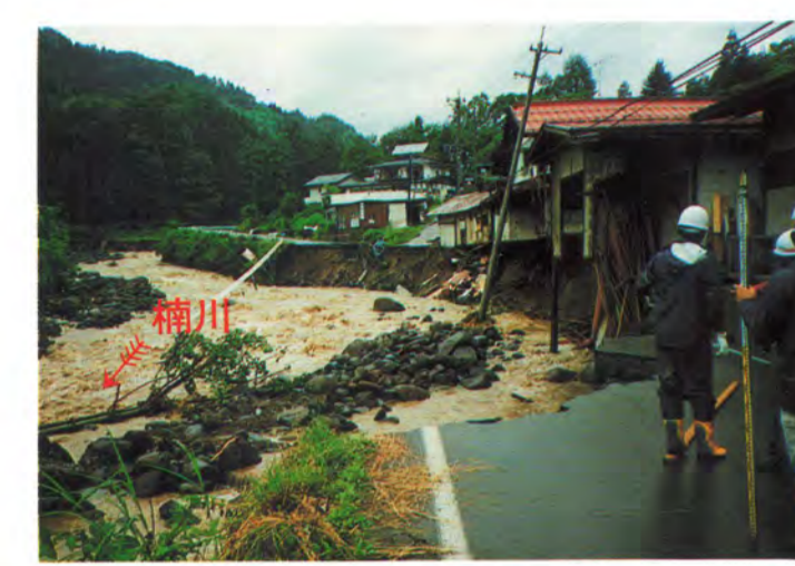
戸隠村折橋(道路決壊)
