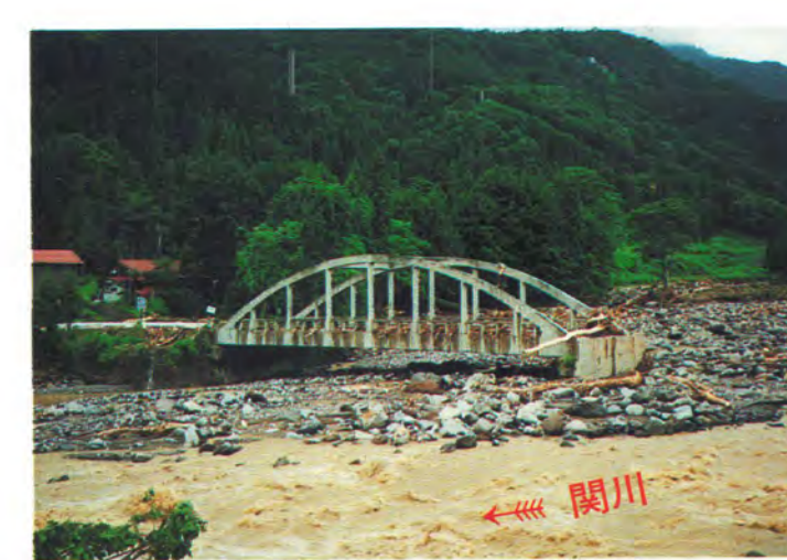
信濃町高沢(地震橋護岸決壊)
