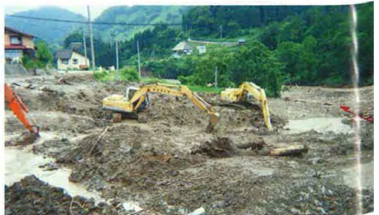
▲7/15 中谷川と十二沢の合流部 被災状況
