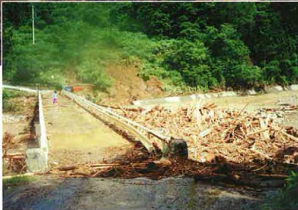
▲7/13 堂田橋から上流 被災状況
