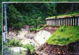
▲7/13 熱湯沢洞門 被災状況
