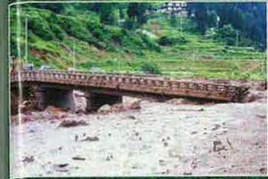
▲7/13 石原橋 被災状況
