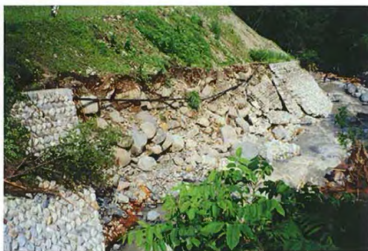
▲小谷村 沓掛付近 被災状況
