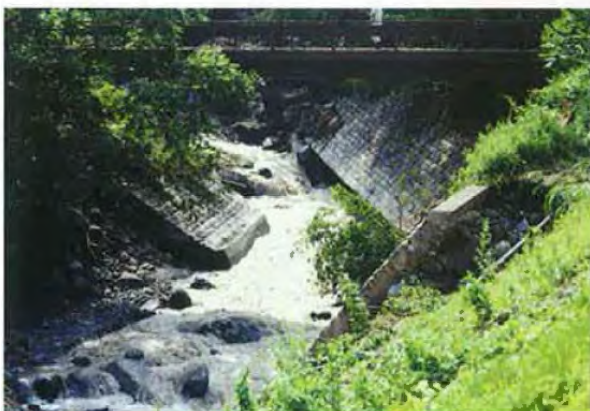
▲小谷村 塩の道付近 被災状況
