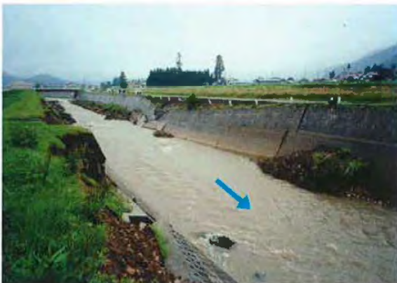
▲姫川、白馬村飯田 被災状況 (7/15 撮影)
