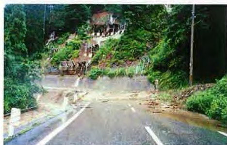
▲真二重橋下 7/12土砂流出状況
