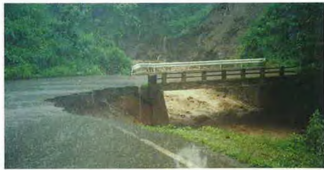
▲7/12 親沢橋、路肩欠壊(親沢川)
