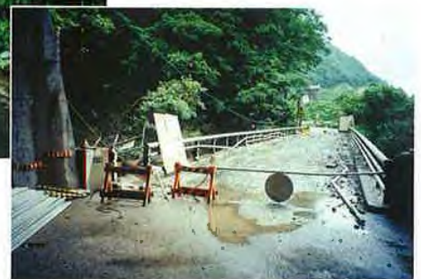
▲土石流により、高欄破損
