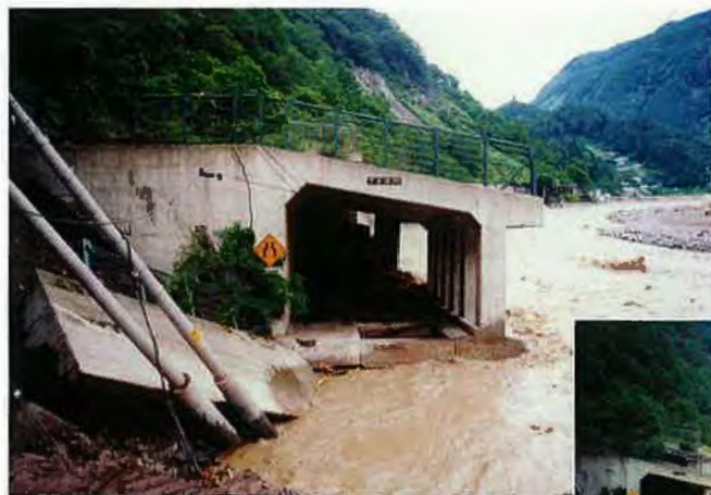
▲7/12 下寺洞門崩壊状況
