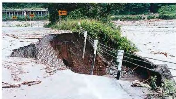
▲7/12 小谷村塩坂 路肩欠壊
