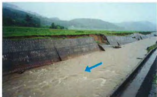
▲姫川、白馬村飯田 被災状況 (7/15 撮影)
