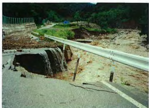
▲7/12 大なで路肩欠壊
