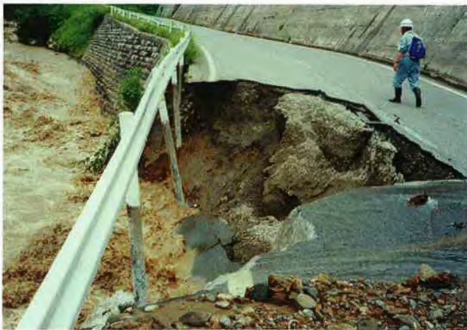
▲7/13 大なで路肩欠壊
