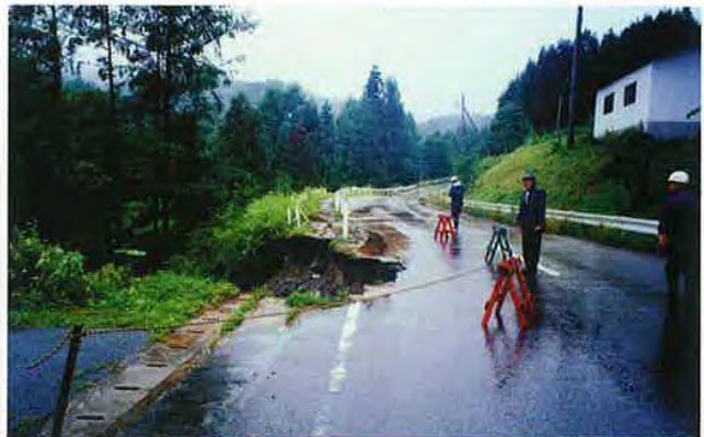
▶7/12 スキー場下 路肩欠壊
