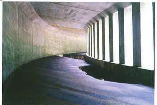
▲洞門内道路欠壊状況
