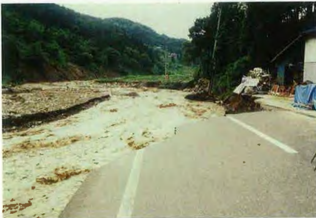
▲7/12 真木、道路欠壊状況
