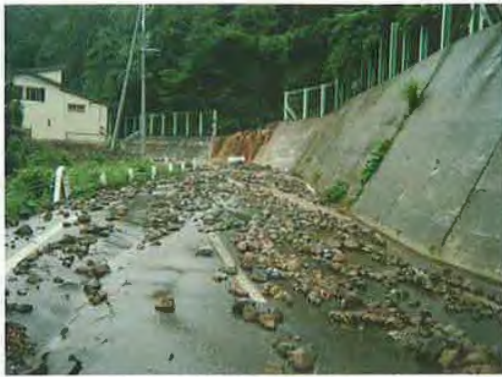
▲7/12 沢からの土砂流出
