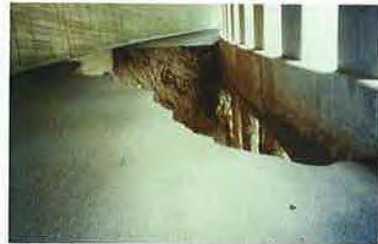
▲洞門内道路欠壊状況
