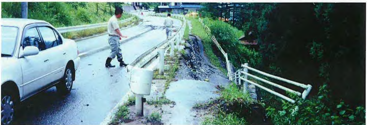
▲7/12 スキー場下 路肩欠壊
