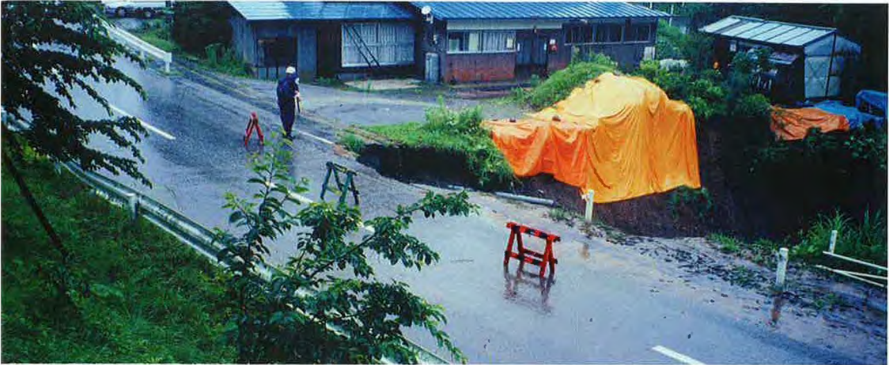
▲7/12 スキー場下 路肩欠壊
