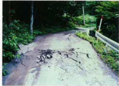
▲7/13 大町市 稲尾地滑り、道路変化
