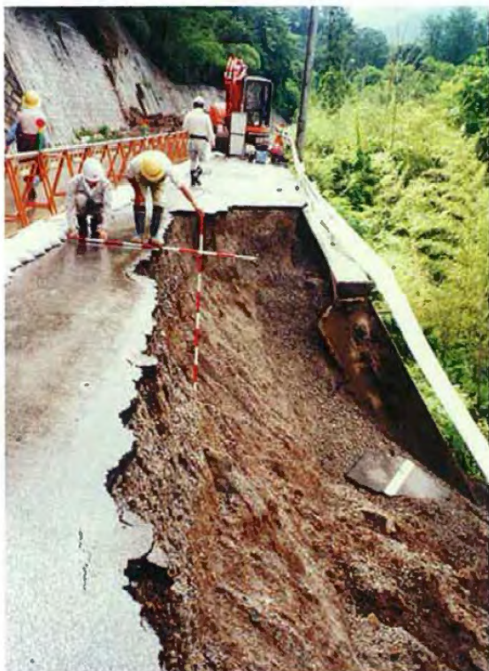
▲7/13 大町麻績インター戸倉線、 八坂村 大滝 路肩欠壊
