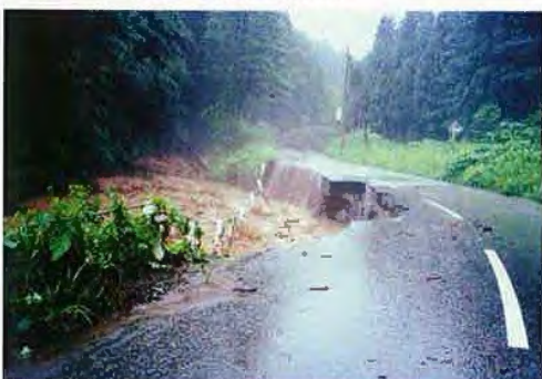
▲藤平 7/12出水、路肩欠壊
