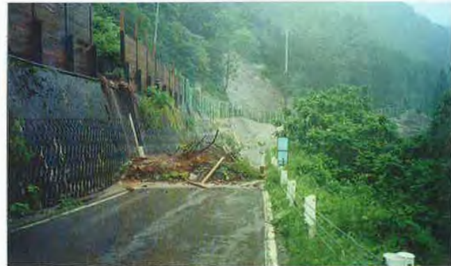
▲7/12 沓掛、土砂崩落
