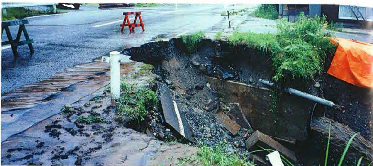
▲7/12 スキー場下 路肩欠壊
