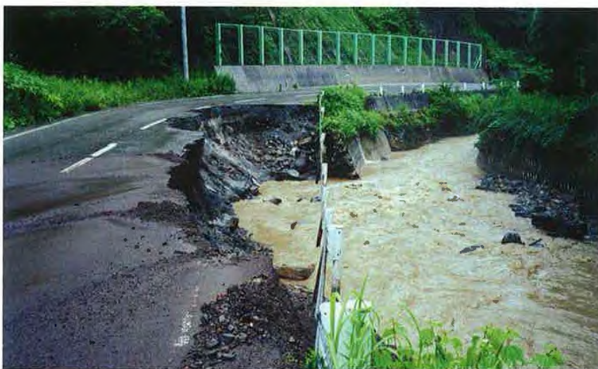
▲7/12 藤平 路肩欠壊状況
