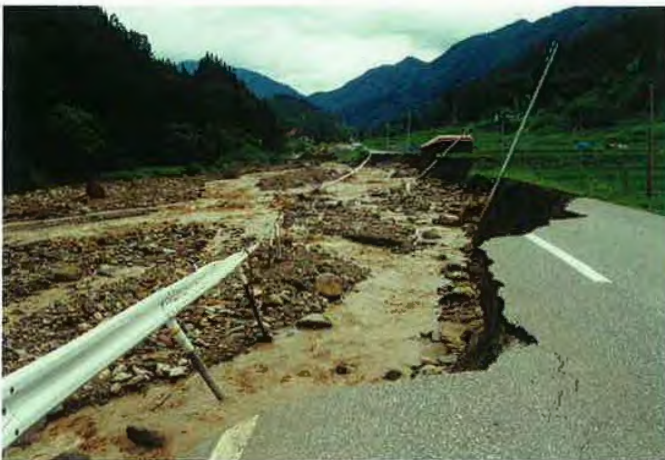
▲7/12 道路欠損状況
