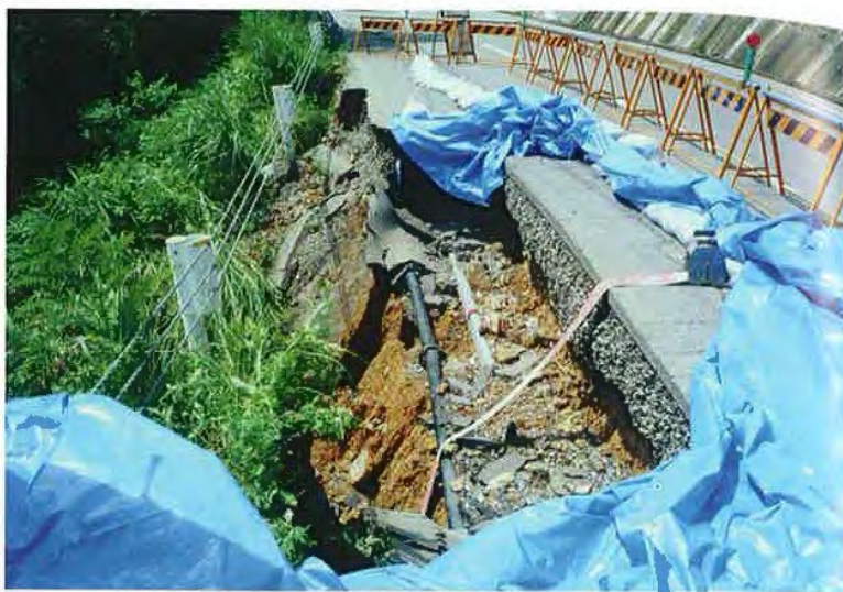
▲瀬戸上、路肩欠壊(光ファイバーケーブル3条) (7/13 撮影)
