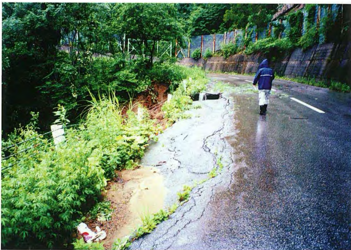
▲7/12 白沢 路肩欠壊
