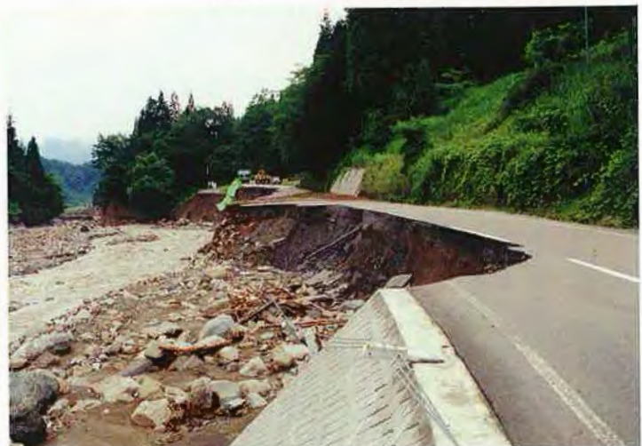
▲7/12 真木洞門下 路肩欠壊状況
