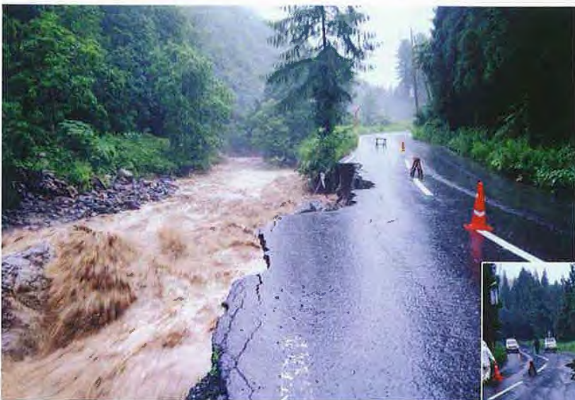
▲7/12 瀬戸、路肩欠壊(楠川)
