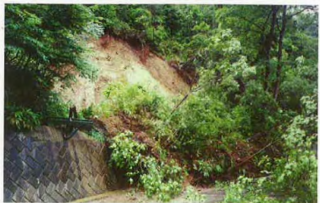
▲塩ノ川、土砂崩落状況 (7/12 撮影)
