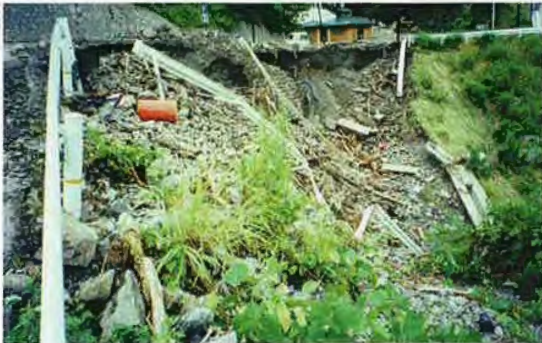
▲7/12 道路欠損状況
