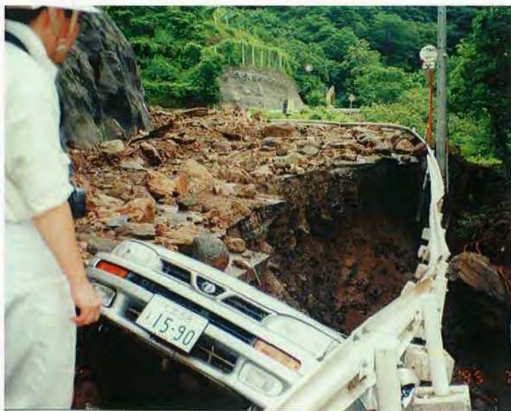
▲7/13 小山沢北、路肩欠壊状況
