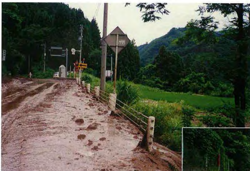
▲7/13 土砂流出状況
