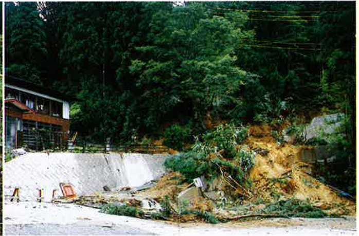
▲民家脇に崩落してきた土砂
