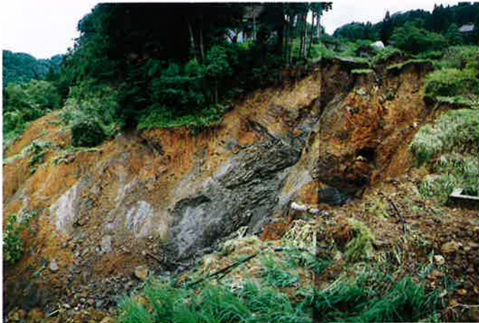
▲滑落崖 上部に民家がある
