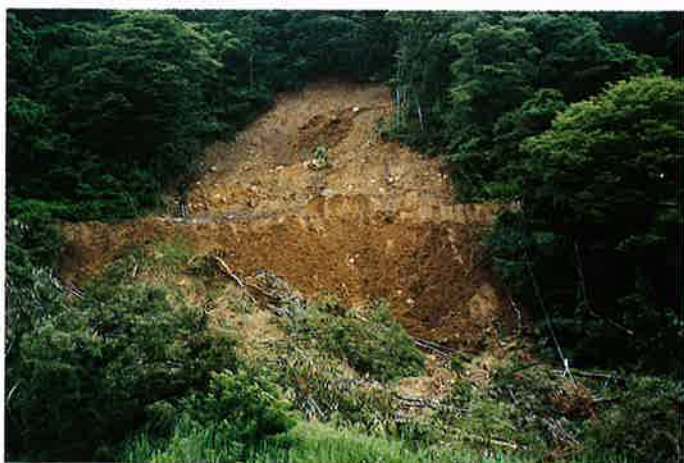
▲法面崩壊状況
