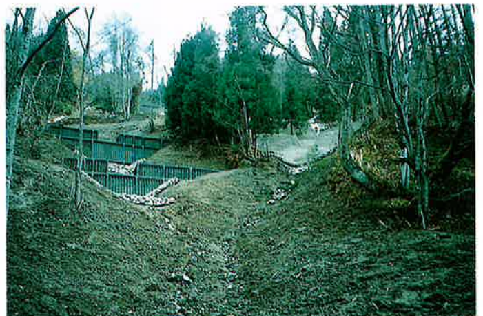
▲崩壊した土砂の下流への流出を防ぐ谷止工
