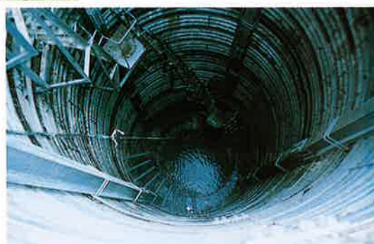
▲集水井 9本の集水ボーリングの先から水が落ちる
