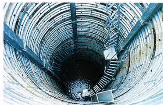
▲深く井戸を掘り横ボーリングにより水を抜く 集水井工内部
