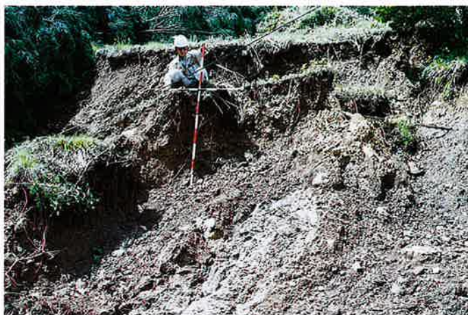
▲地すべり頭部 すべり状況
