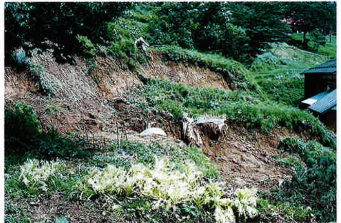
▲地すべり中央部 すべり状況
