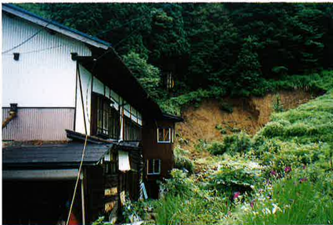
◀ 民家裏地すべり発生1棟半壊
