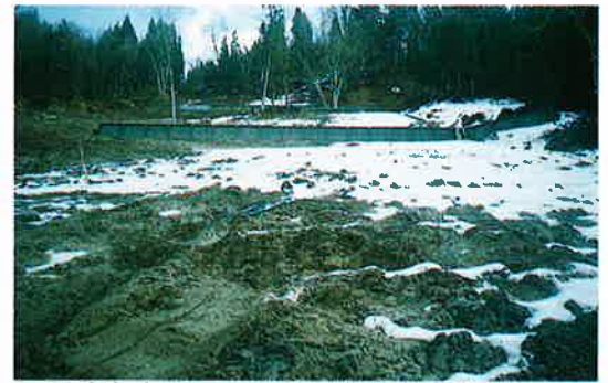
▲土砂を止めることを目的に施工した鋼製自在枠土留工
