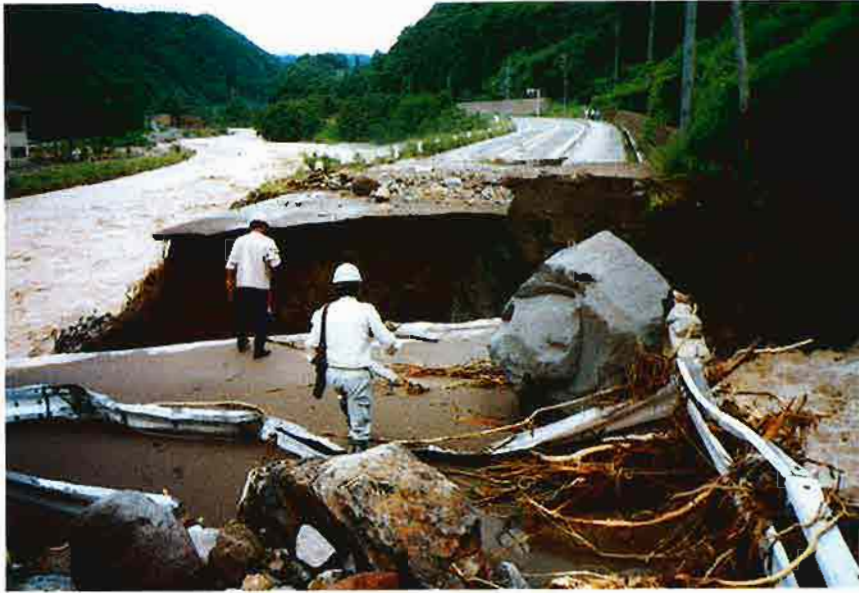
土石流で切断された道路
