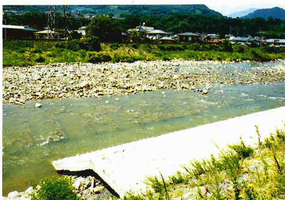
被害がなかった木工沈床の根固
