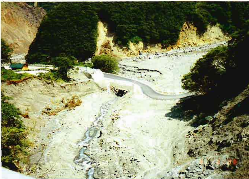
新潟県管理の橋を協議により 長野県で復旧することになった。
