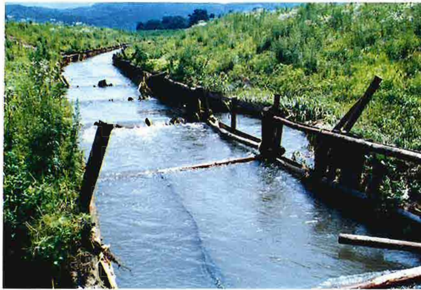
被災した木柵工
