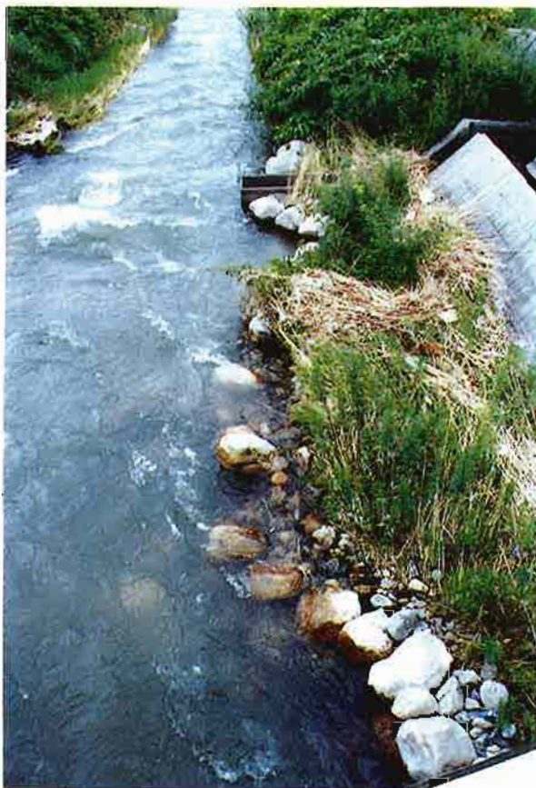
約2 m崩れた空石積
