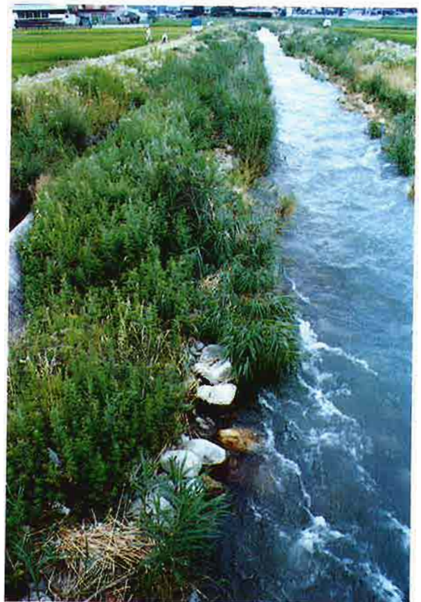
石1個崩れた空石積
