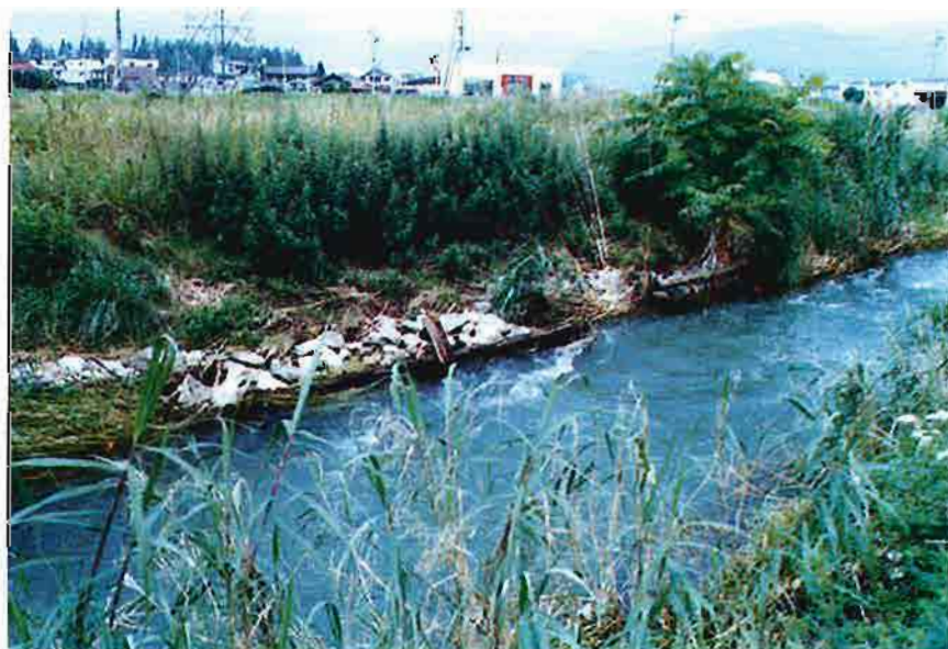
被災した杭柵工
