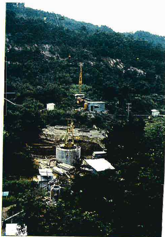
写真-67 1号集水井筒（ケーソン工）施工中の状況。 1969年（昭和44年）撮影。
