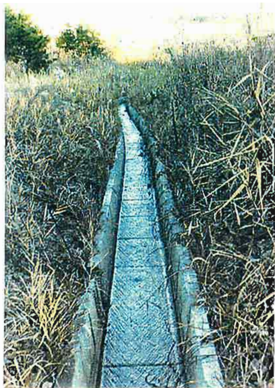
写真-68 Y～Y測線付近の水路工。 1976年（昭和51年）1月撮影。
