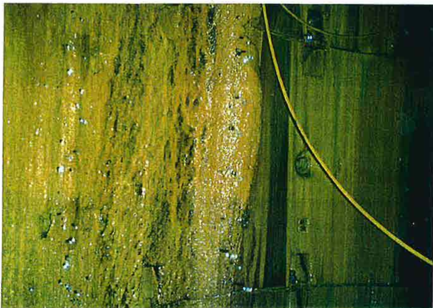
写真-77 RCセグメ ント集水井の 内壁に付着し た鉄サビ。1992 年(平成4年)7 月撮影。
