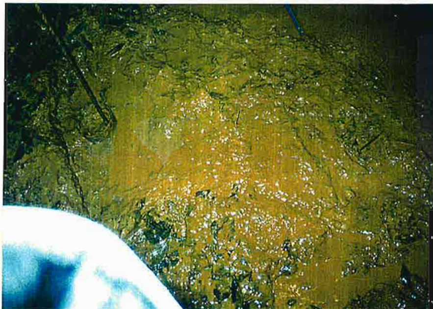
写真-78 RCセグメ ント集水井の 底の状況。ト ンネルへ落と す導水管の口 もサビでつま る。1992年(平 成4年)7月撮 影。
