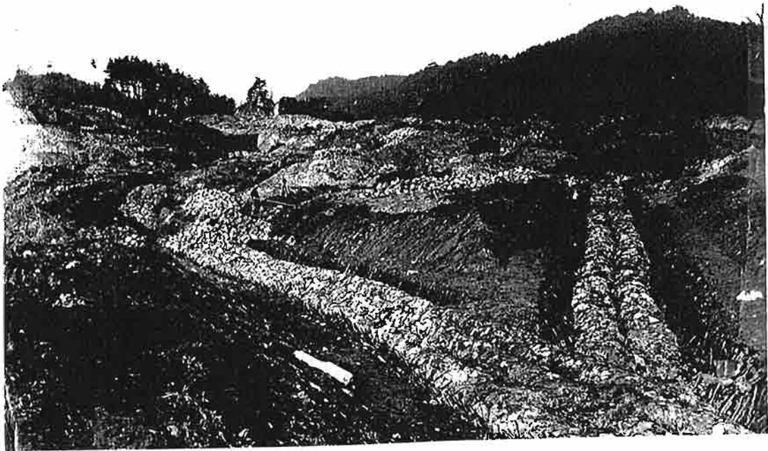
写真-21 山新田集落 西南の蛇籠水 路工事施工 中の状況。1933 年(昭和8年)12 月撮影。
