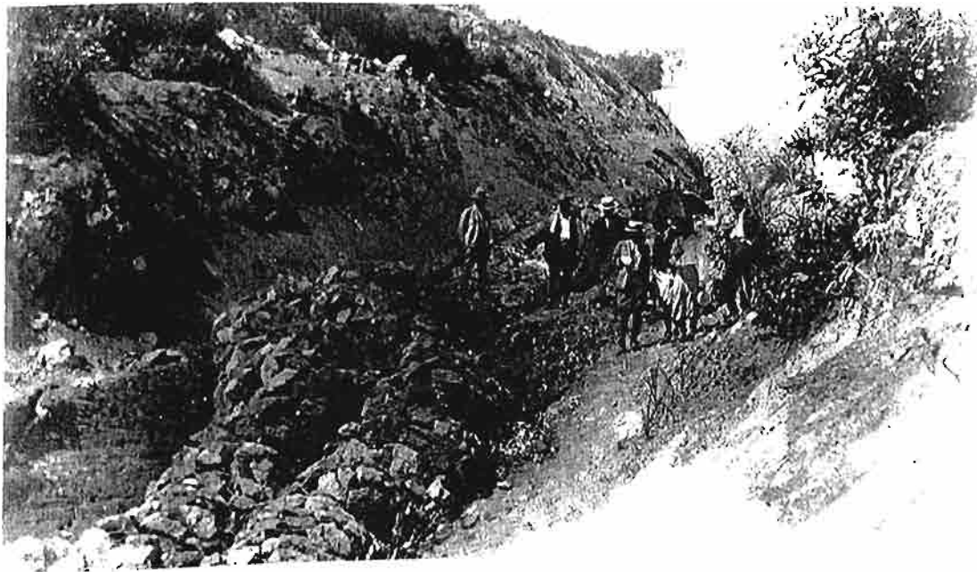
写真-24 昭和7年度 施工の蛇籠水 路工の変形状 況。1933年(昭 和8年)10月撮 影。
