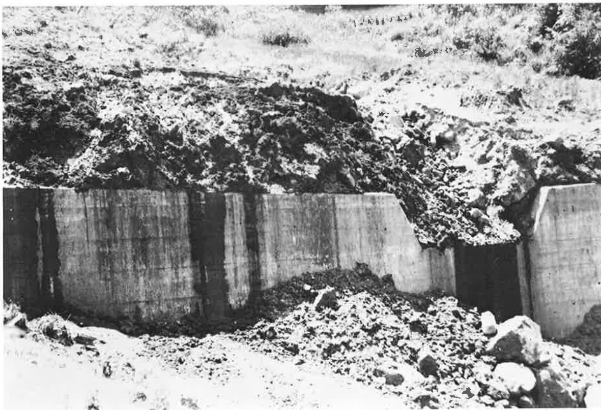
写真-3 ↑ 滝沢川に施工した砂防ダム（長42.0m 高10.0m）が埋没しつつある状況 昭和24年（1949）12月撮影
