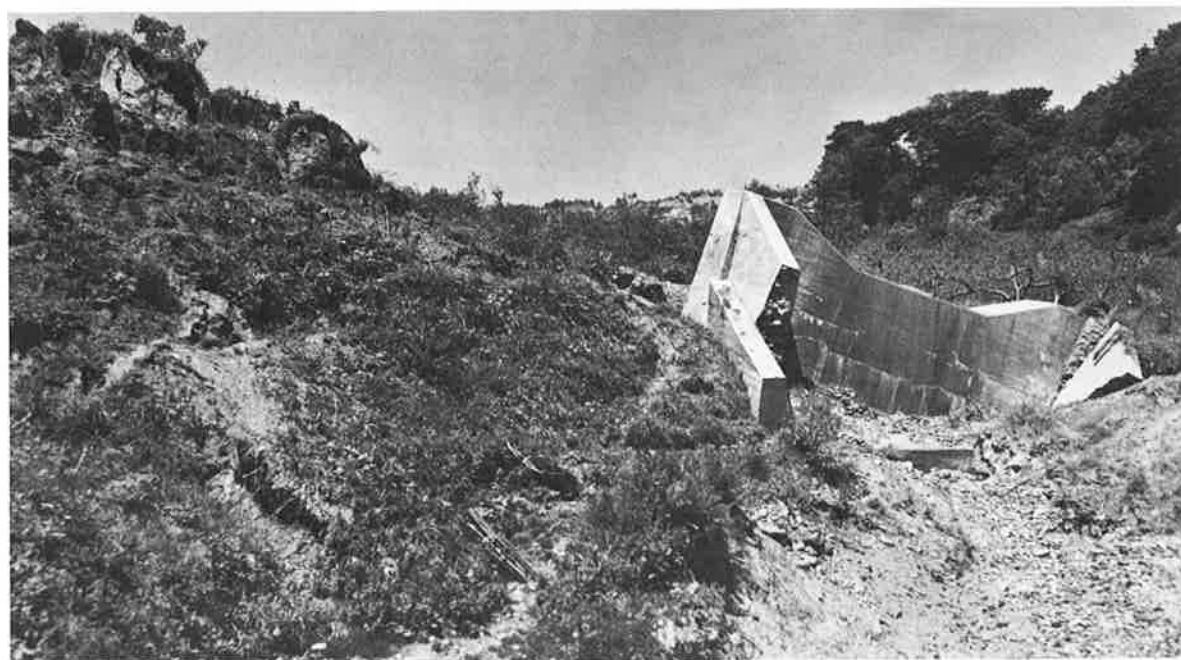
写真-4 ↑ 滝沢川沿いに押し出した地すべり土塊により床止工がもち上げられた状況 昭和11年（1936）6月撮影
