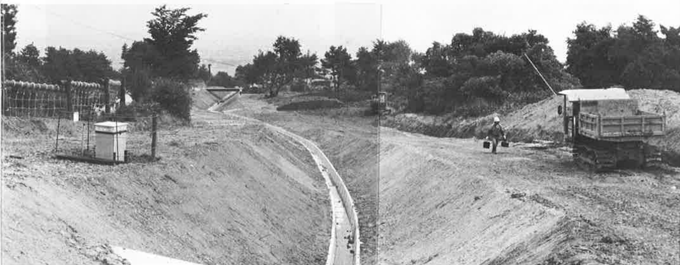
写真-7 ↑ 地すべり地下部（Y-Y測線下方）水路工整備中の状況 昭和56年8月
