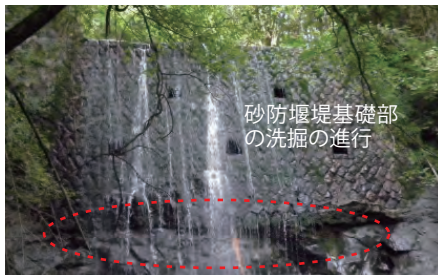
砂防設備の損傷 砂防堰堤の基礎部の異常洗掘による施設安定性の低下
