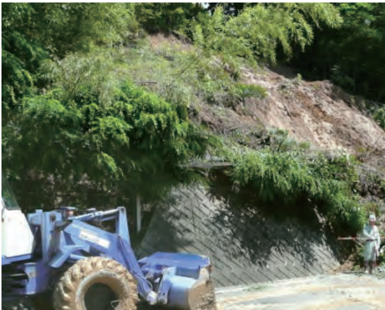
地すべり発生状況
