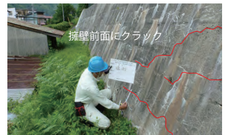
急傾斜地崩壊防止施設の劣化 斜面保護機能及び施設安定性の低下
