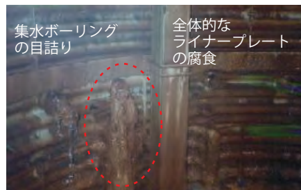
地すべり防止施設の劣化 排水機能の低下、集水井の主要部材の劣化
