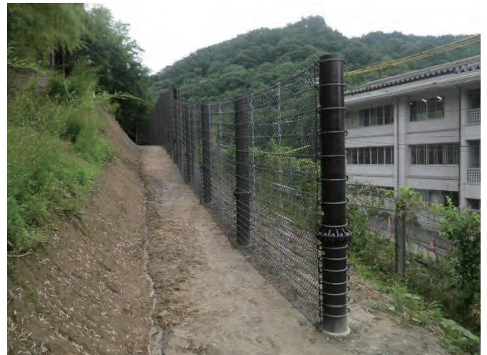
避難所(中学校)を守る崩壊土砂防止柵工 (大町市 東大塚)
