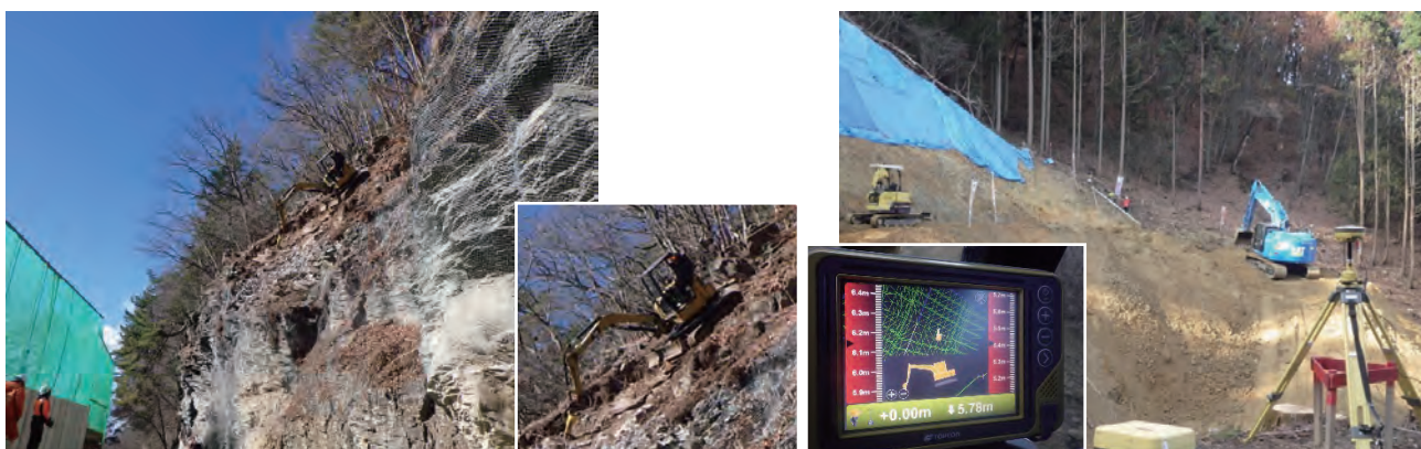
横谷温泉地区（茅野市）斜面对策 ICT建機による無人化施工状況 樽沢川（高山村）1号堰堤 ICT土工施工状況
