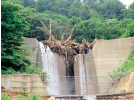
平成29年5月飯山市井出川山腹崩落災害で発生した土砂及び流木を捕捉した飯山市桑名川砂防堰堤
